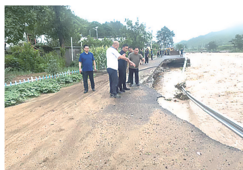
近日,面对连续强降雨,平山县地方道路管理站紧急部署,要求全员在岗,物资准备充分,同时积极开展应急抢险工作。目前,该站共出动抢险人员35人次,出动铲车22辆、勾机7辆、翻斗车9台次,清理塌方35处,对4处隐患点均已设置警示标志,作断交处理,并派专人看守,最大限度减轻灾害损失。图为该站人员一处塌方点展开全面排查,制定处置方案。张锡霞 韩磊 摄
