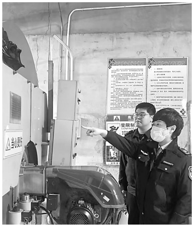
图为市场监管工作人员对企业锅炉进行检查。
